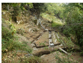
Filière d'infiltration pour sortie d'un bac à graisse
