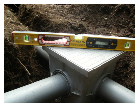
Regard de répartition de niveau
