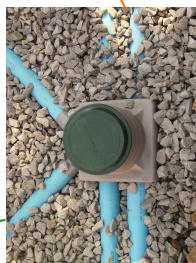
Regard de répartition
